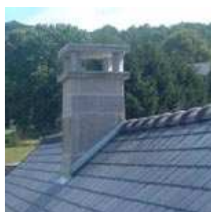
Une souche conforme
