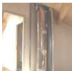
Ecart au feu en plafond
